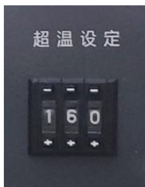
超温保护器位于机器正面的控制面板
